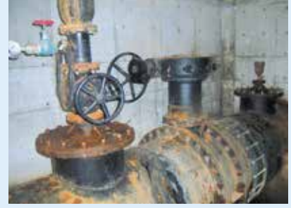
老朽化が進んだ用水供給施設
