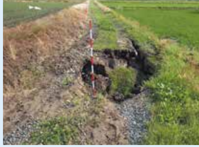
漏水による農道の陥没
