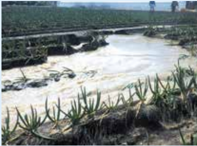
第2号導水路漏水状況
