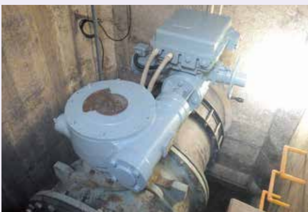
電動制水弁本体
