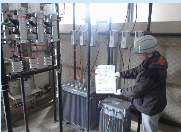
柘揚水機 高圧電気設備
