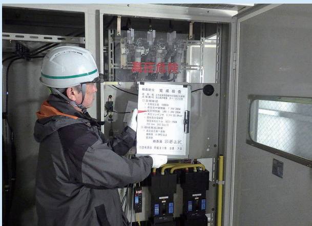
栗山揚水機 高圧電気設備
