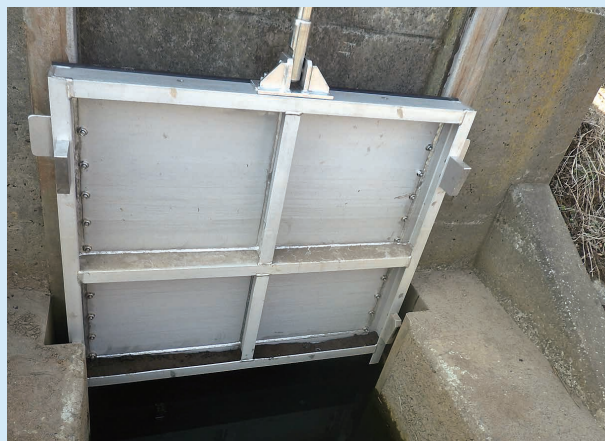
天神揚水機 取水ゲート
