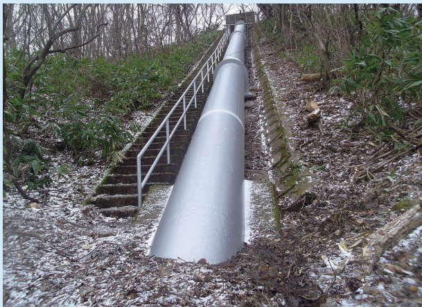
埴川支線用水路露出管
