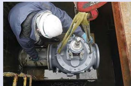
大台野地区 減圧弁
