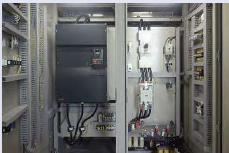
大台野揚水機 電気設備
